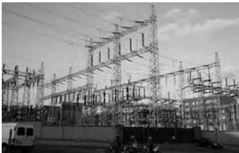
Subestació transformadora de FECSA de Sant Boi. Foto: Àlex Tarroja
