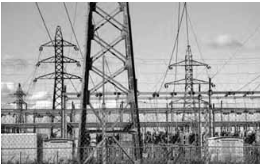
Detall de l'estació elèctrica de Baixàs, al Rosselló. Foto: Àlex Tarroja
