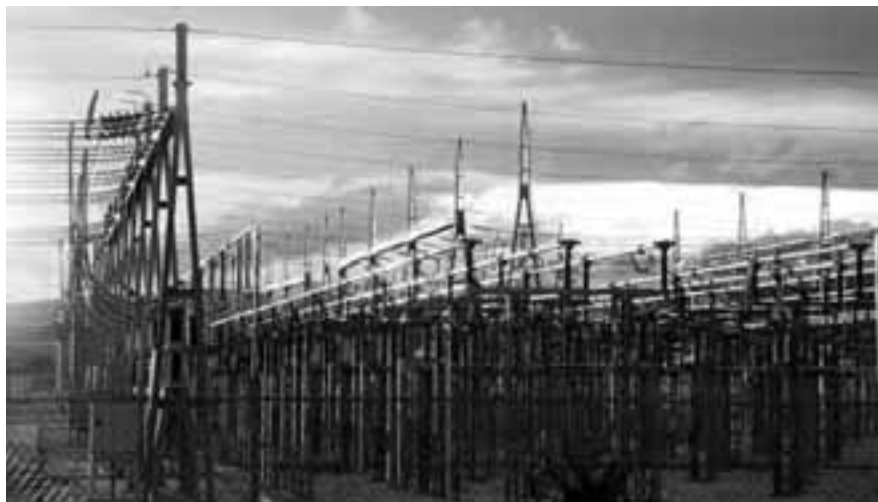
Detall de l'estació elèctrica de Baixàs, al Rosselló. Foto: Àlex Tarroja
